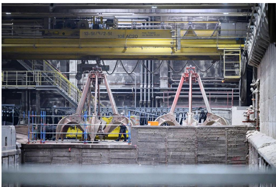
Abbildung 104. Moderne Abfallverwertung: Blick in das Müllheizkraftwerk
