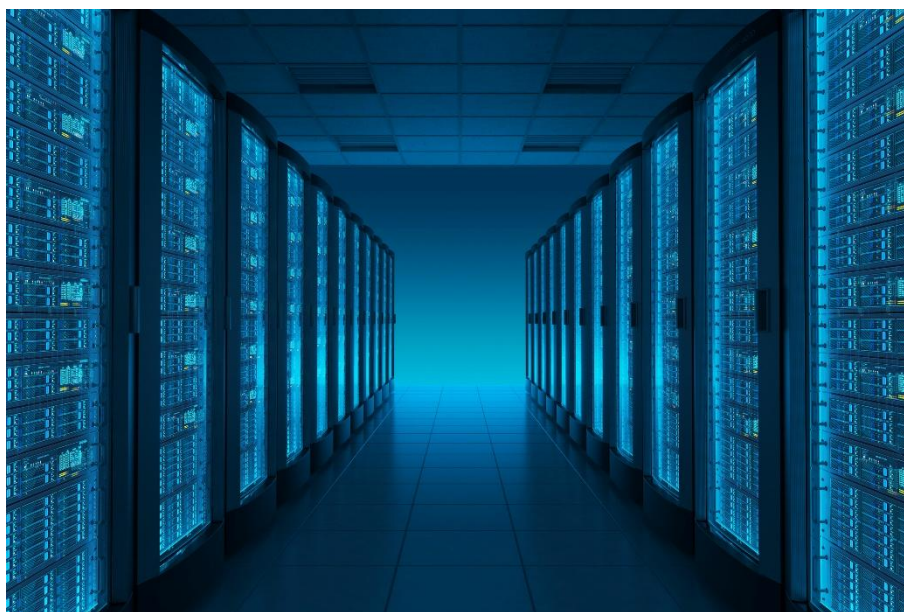
Abbildung 101. Rechenzentrum mit Serverracks
