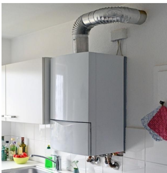
Abbildung 93. Gastherme als Übergangslösung für die Wärmeversorgung
