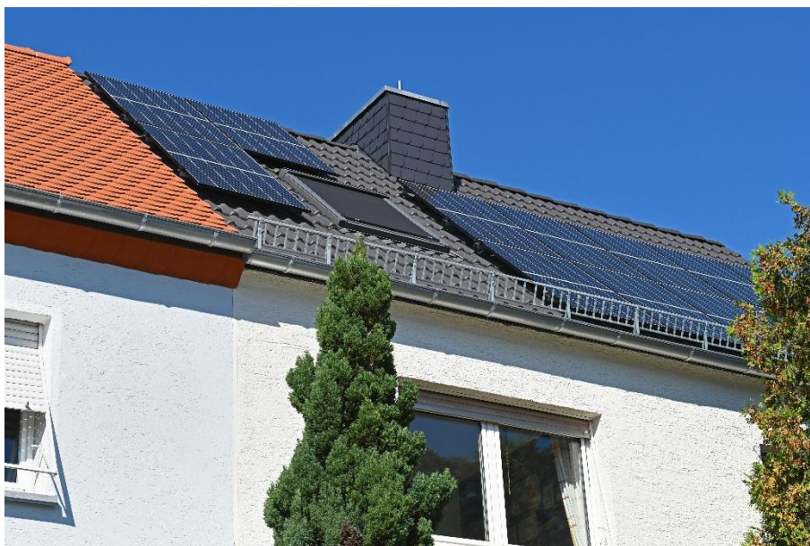
Abbildung 113. Energetische Modernisierung durch Solartechnik
